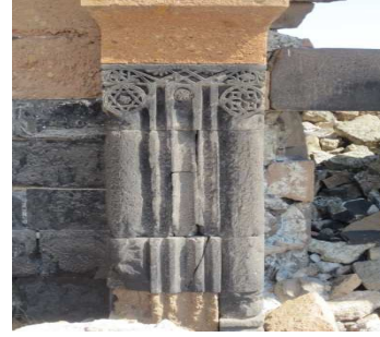
Kuzey duvardaki plaster
